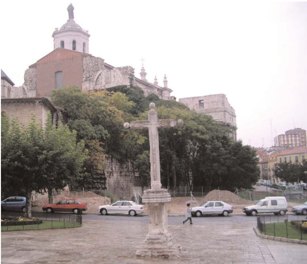
Las obras de acondicionamiento del entorno de la plaza Portugalete recuperarán el entorno original de la Catedral.
